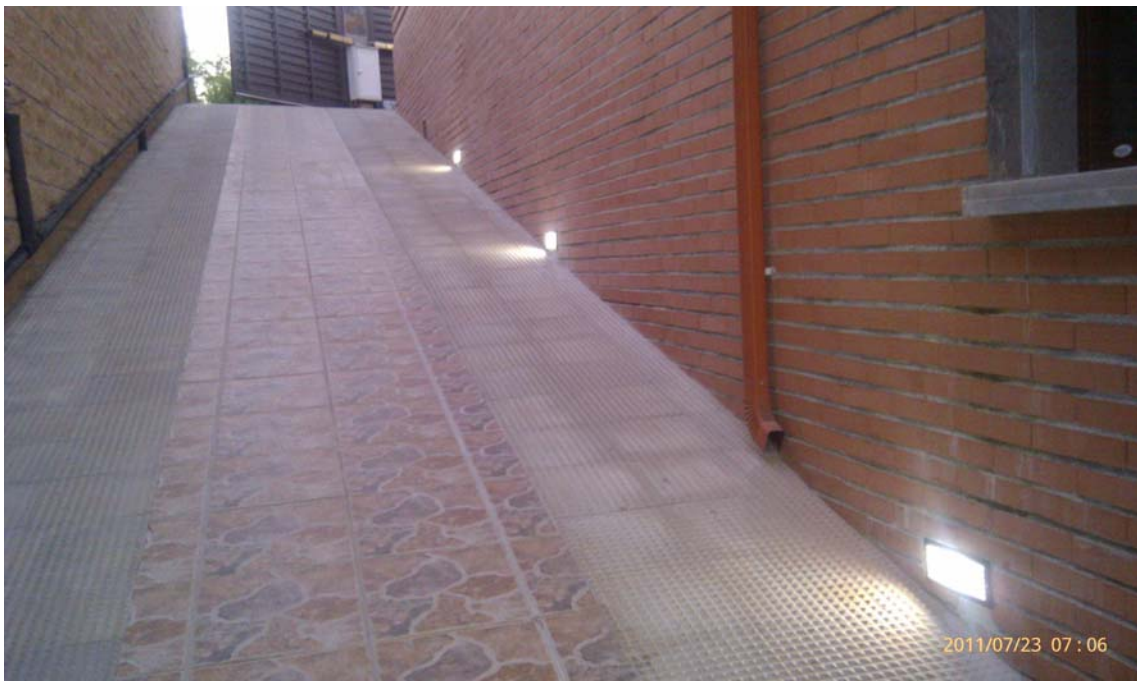
Rampa norte. Primer plano en bajo derecha: iluminación de rampa para acceso nocturno de vehículos, con encendido simultáneo a la apertura de puertas basculantes de nivel Calle Mistral. Fondo izquierda: puerta basculante nº 2 semi-abierta.
