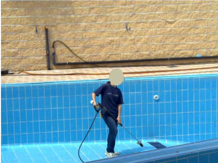
Tareas de mantenimiento previas a temporada de baño. Piscina de juegos vacía. Limpieza mediante hidrolimpiadora Karcher conectada a punto de presión perimetral.
