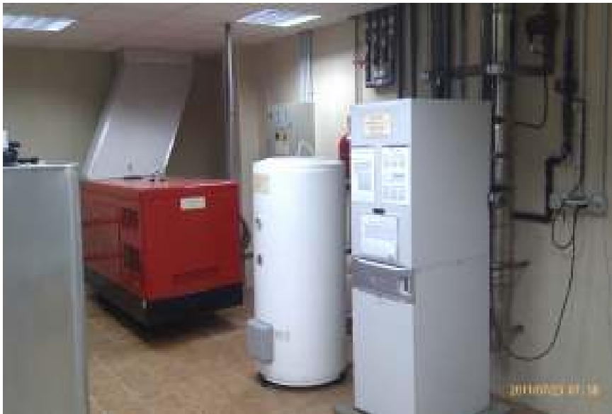
La salle des machines. Devant: la chaudière et échangeur de chaleur solaire pour l'eau potable, la cheminée désenfumage, la sonde de la température, des conduites et des valves. Derrière (ce n'est pas visible): circulateur des panneaux solaires pour le chauffage et vases d'expansion. Fond: générateur triphasé isolé (30KVA), système d'évacuation de fumées et panneau de contrôle automatique.
