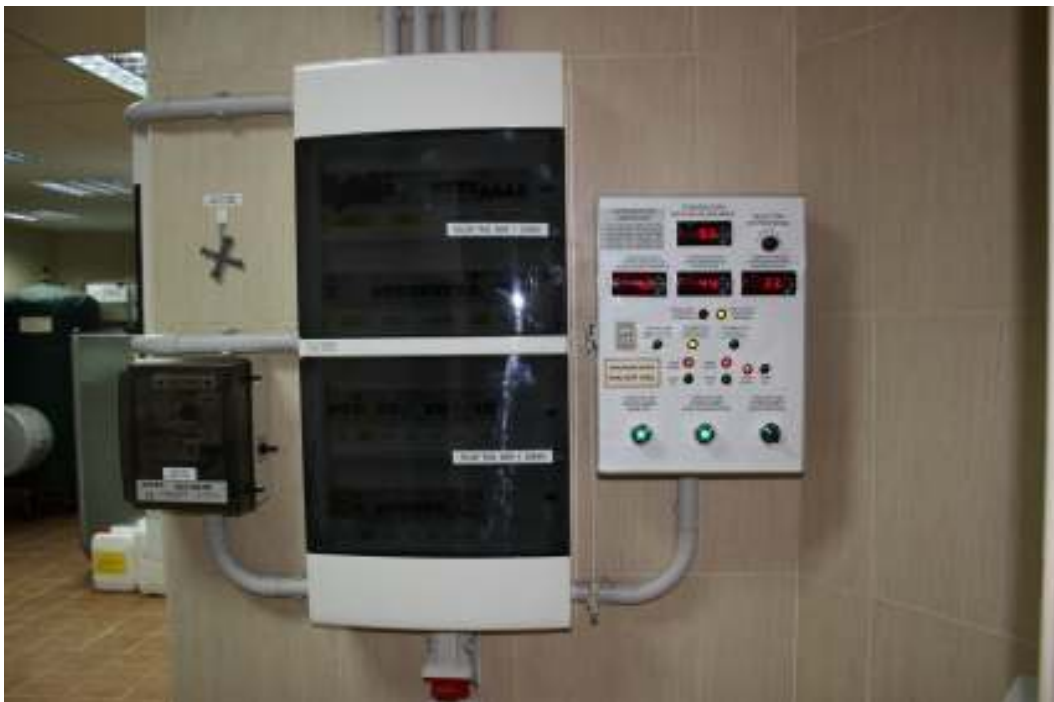
La salle des machines. Devant: 3 des 8 panneaux de commande. Gauche à droite: le panneau du puits, le panneau principal de la salle des machines et le panneau d'automate solaire. Tous les mécanismes sont haut de gamme (Schneider Electric ®).
